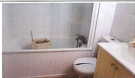
Photo PhEle001 Localisation : Général Libellé de l'anomalie : B5.3 a Locaux contenant une baignoire ou une douche : la continuité électrique de la liaison équipotentielle supplémentaire, reliant les éléments conducteurs et les masses des matériels électriques, n'est pas satisfaisante (résistance supérieure à 2 ohms). Remarques : La LES (Liaison Equipotentielle Supplémentaire) est incomplète - Absente sur bonde Baignoire ; Faire intervenir un électricien qualifié afin de compléter la LES (Salle de bain - Wc)
