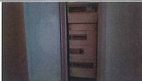
Photo Tableau Electrique + Différentiels Localisation : Chambre 1
